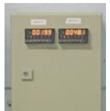
Einfach ablesbares Materialgewicht im Silo.
