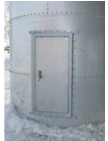
Verschlussbare Tür ermöglicht den Zugang zum Konus.
