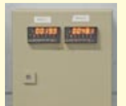
Enkelt aflæsning af vægt i silo.
