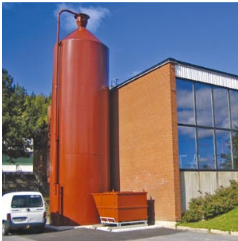
MAFA BIB 85 silo (85m 3 ) vid Helledalsskolan, Ramvik.
