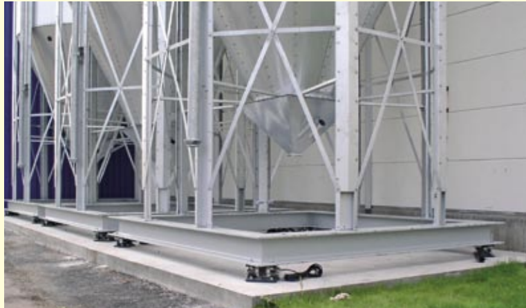
MAFA's siloer kan komplementeres med vejesystem som giver den præcise oversigt leveringer, lagerstatus og forbrug.
