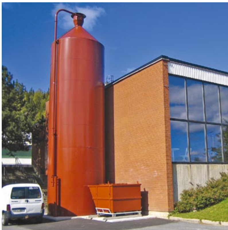
MAFA BIB 85 silo (85 m 3 ) ved Helledalsskolan, Ramvik
